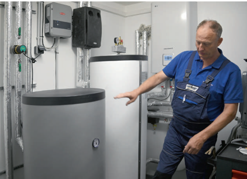
Heizungsbauer Rolf Schöll setzt längst auf neue Technologien, doch klare Fahrpläne seitens der Politik fehlen.
